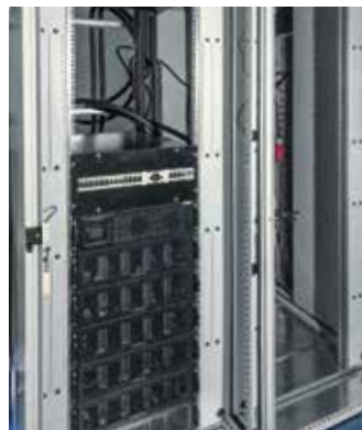
Technik-Rack in der Bauphase mit USV-Anlage und Battery-Pack von SCHÄFER IT-Systems.
