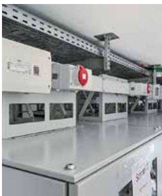
Oberliegende Kabeltrassen mit Abgangskästen und Stromschienen.
