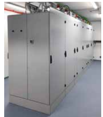
Rückseitige Ansicht der IS-1 Racks mit oberliegender Kabeltrasse und Abgangskästen.
