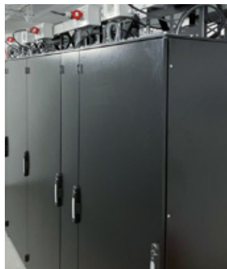
Rückseitige Ansicht der IS-1 Racks mit oben liegender Kabeltrasse und Abgangskästen.
