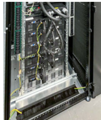
Rückansicht Technikrack mit bauseitiger Zuleitung, Abgängen zu den Stromschienen sowie SCHÄFER Smart PDUs.
