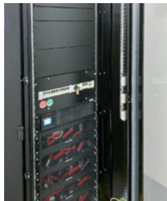
Das Herzstück der Anlage: Technikrack mit Powerbox und USV-Anlage von SCHÄFER IT-Systems.
